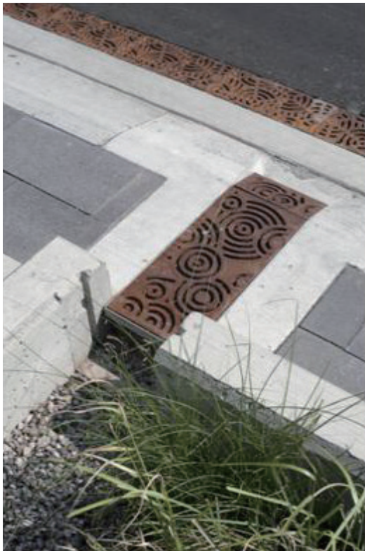
도로경계석과 플랜터를 연결하는 수로
